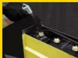
バッテリー上部に吹きつけ
